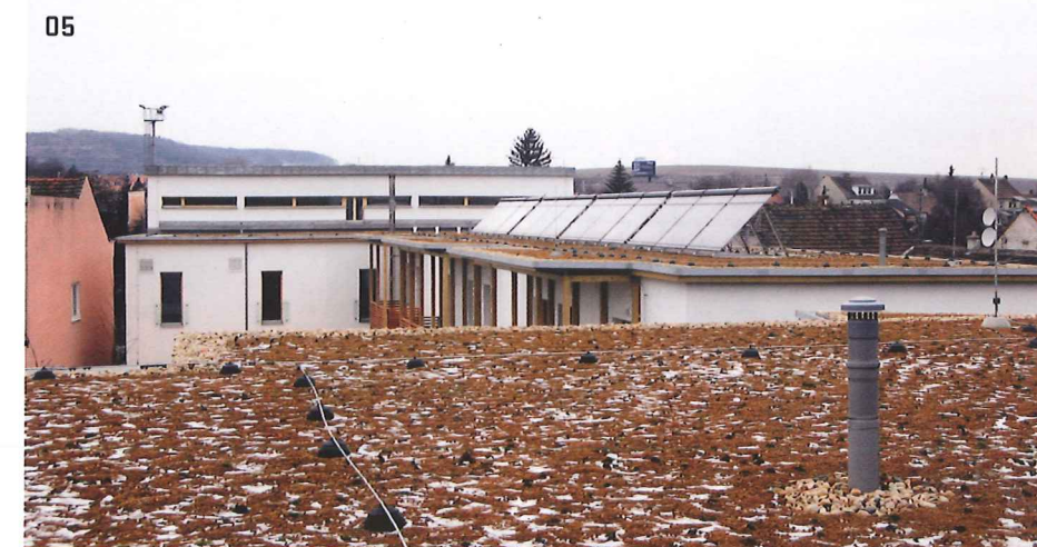
05 &gt; Na zelených střeších jsou solární trubkové termické kolektory Viessmann Vitosol 300 T pro přípravu teplé vody
