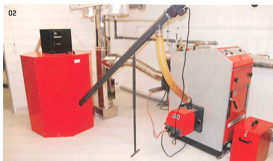
02 &gt; Hlavní zdroj tepla, kotel značky Atmos na dřevěné pelety
