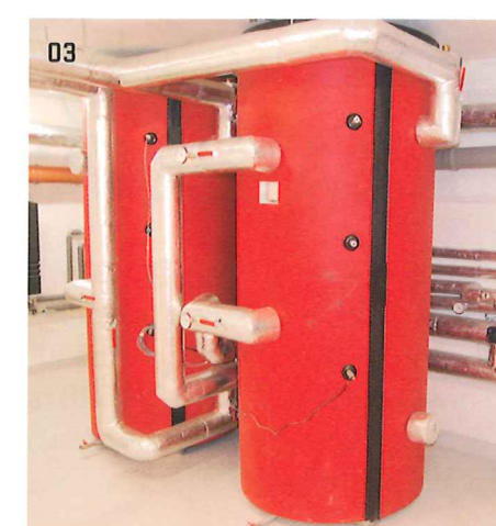
03 &gt; Zásobníky tepla se stratifikací ELTO, 1.700 l, oběhová čerpadla Grundfos
