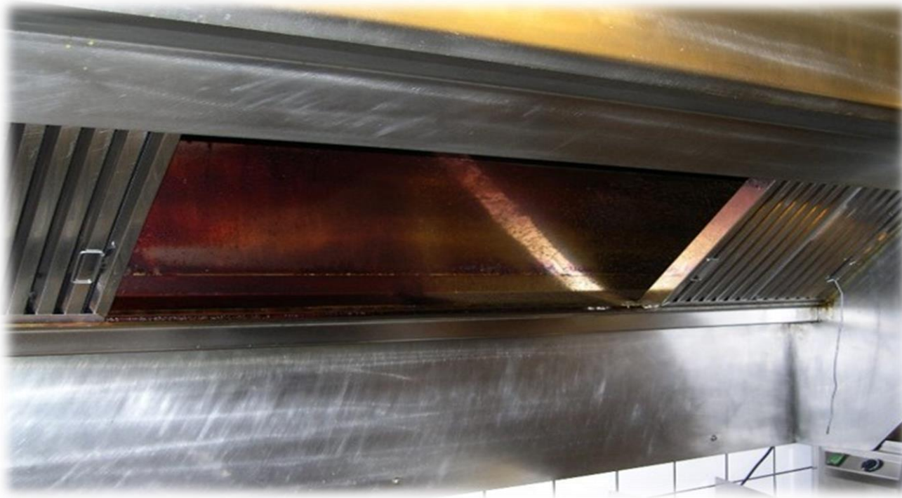
Digestoř bez UV-C filtrace
