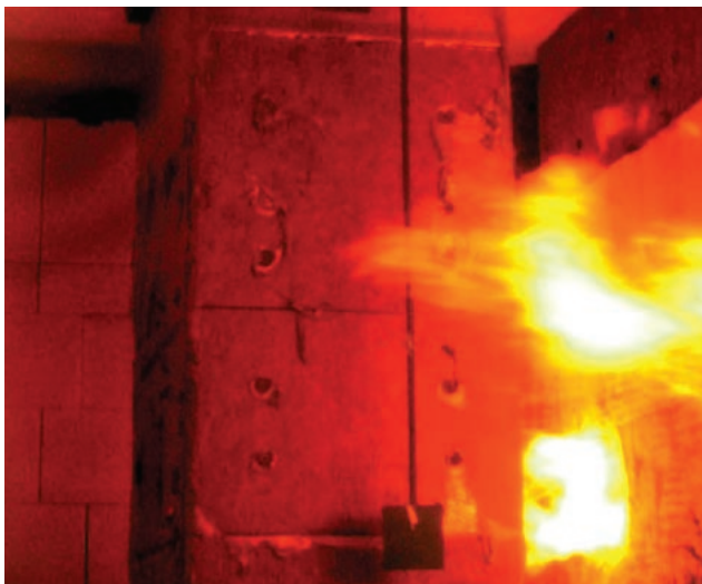
Obr. 4 Pohled na VZT potrubí při zkoušce podle ČSN EN 1366-1 při působení ohně zvnějšku (potrubí typu A)
