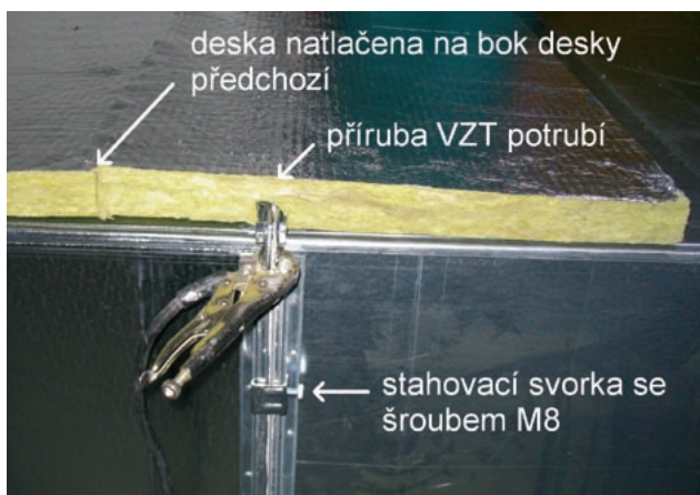
Obr. 18 Spojе izolačních desek leží mimo příruby VZT potrubí
