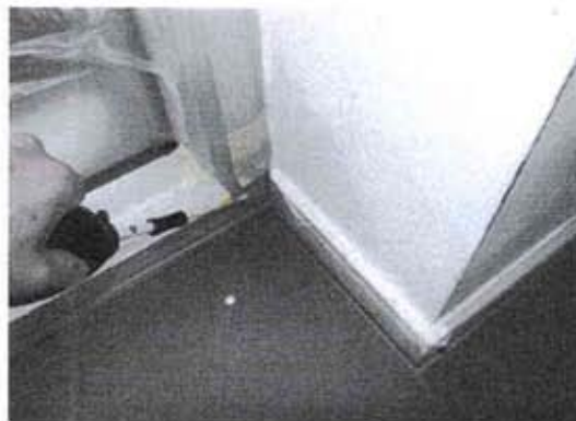
◀ Netěsný roh okna hlavního jižního zasklení 1NP připojovací spára
