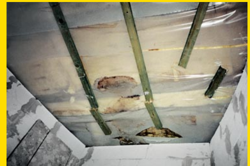
Ukázka možných důsledků kondenzace u šikmé střechy
