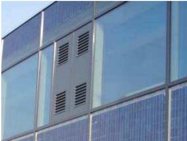
Nasávání čerstvého vzduchu na fasádě
