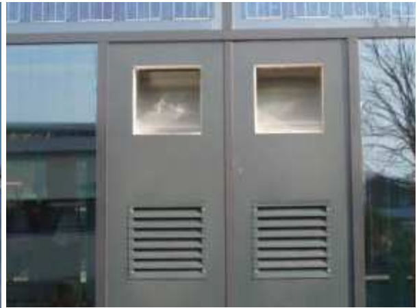
Výfuk odpadního vzduchu
