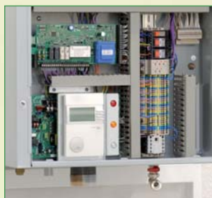
Řídicí jednotka tepelného čerpadla a řízení. Přehledná konstrukce a velmi jednoduchá údržba.
