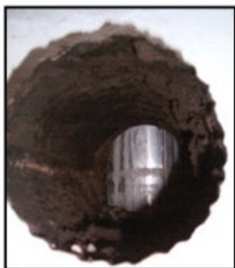
Obr. 5 - Pohled do sopouchu po provedeném vložkování komína bez přípojovací tvarovky. Celý objem spalin pronikal do prostoru koupelny a měl za následek smrtelnou otravu.
