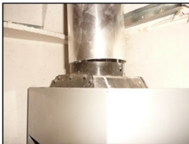
Obr. 4 - Únik spalin do koupelny v důsledku chybného napojení kouřovodu na hrdlo spotřebiče.
