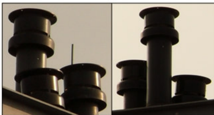
Obr. 6 a 7 - Chybné vyústění odvodu spalin a sání vzduchu od plynového spotřebiče typu C, které má za následek vypadávání spotřebiče z provozu v důsledku přisávání spalin do sání vzduchu pro spalování.
