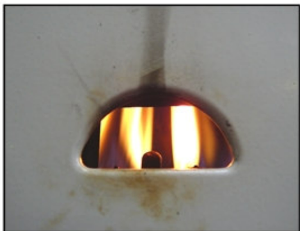
Obr. 3 - Svítivý plamen nedokonalého spalování v důsledku zaneseného výměníku viz obr. 2
