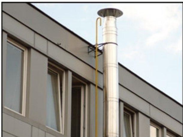
Obr. 15 - Chybné vyústění odvětrávacího potrubí, které v průběhu odvětrávání naplnilo otevřeným oknem přilehlou místnost.
