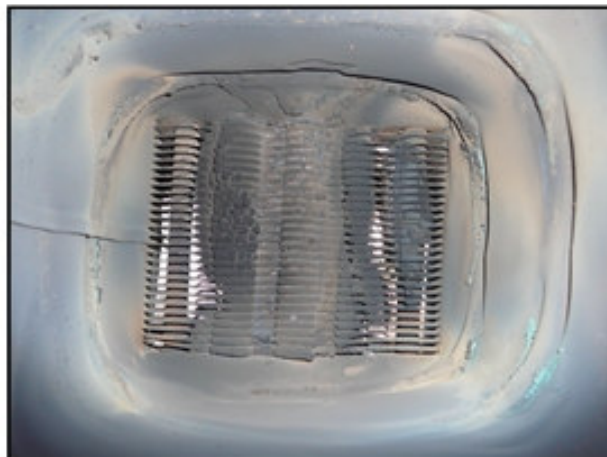
Obr. 2 - Zcela zanesený výměník plynového průtokového ohříváče vody bez odvodu spalin, který měl za následek smrtelnou otravu CO.
